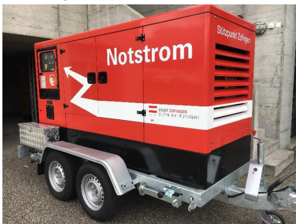
Im Rahmen des Projekts beschaffter Dieselgenerator zur Notstromversorgung des Feuerwehrmagazins.
