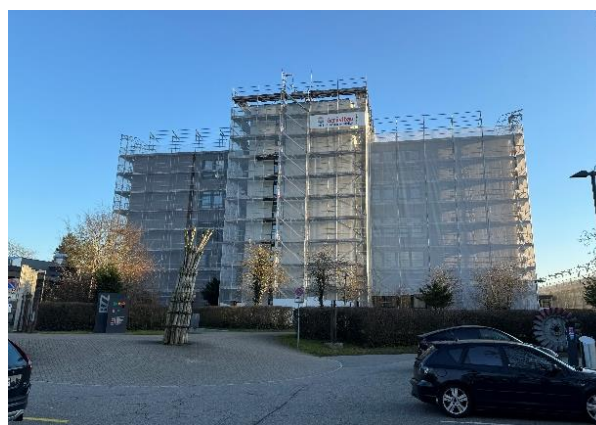
Im Vordergrund steht die Sanierung der bestehenden Gebäudehülle. Bei sieben Gebäuden werden insgesamt rund 500 Fenster ersetzt.
