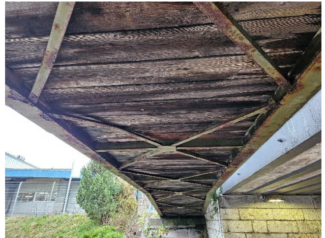
Bild 2: Brückenunterseite mit rostigen Metallträgern
